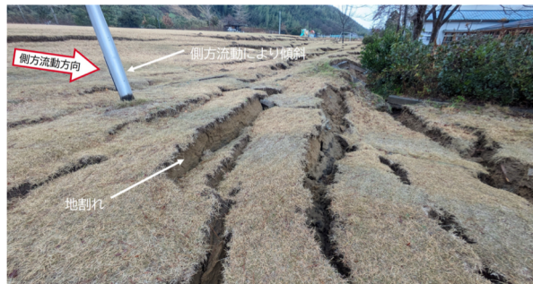
右下・写真広範囲な側方流動による地割れ（石川県内灘町）
